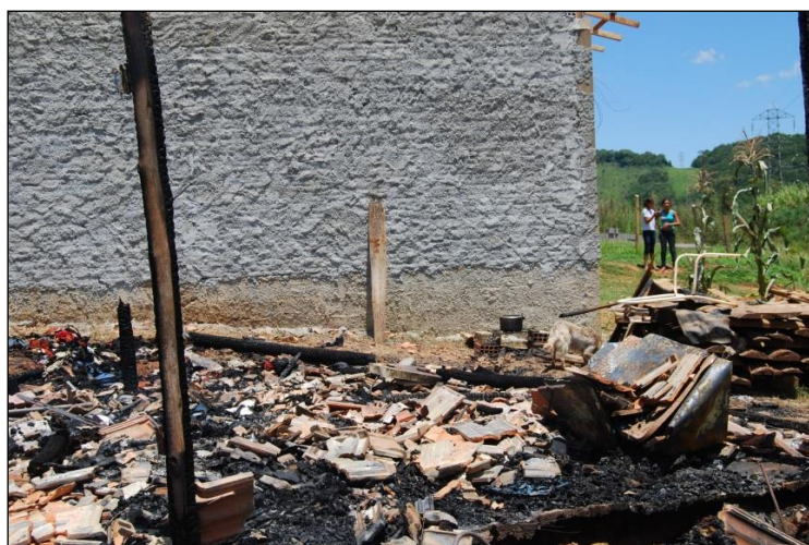
Figura 1 – Imóvel em situação real de incêndio.
