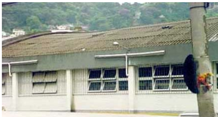
Foto 1 - Vista lateral da estrutura, onde se nota acentuada deformação na linha do telhado.
