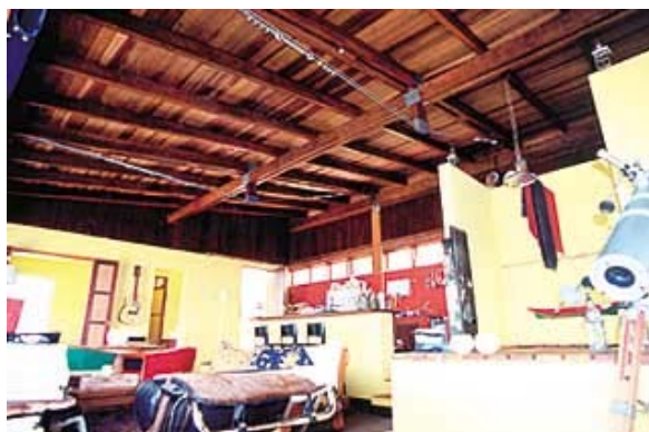
Figura 1 – Viga-vagão utilizada em uma cobertura residencial em Bocaina – SP.
