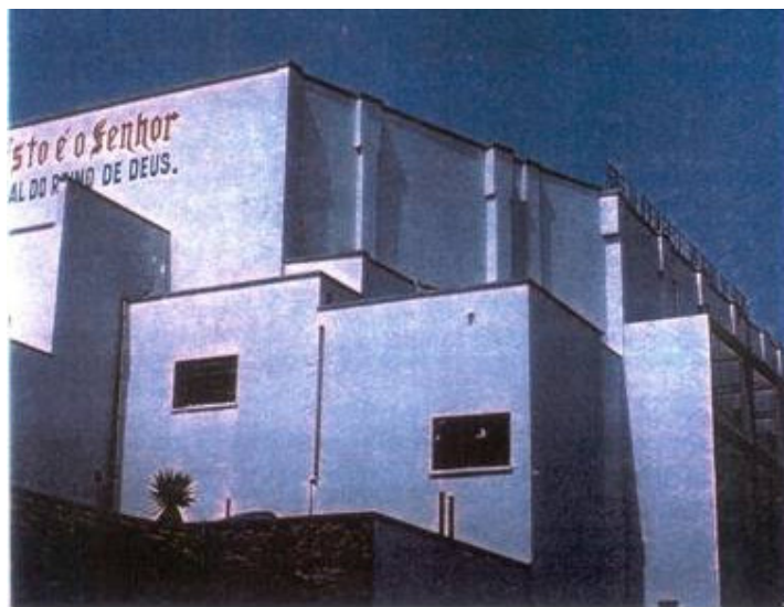
Figura 1 – Vista parcial do templo cuja estrutura de madeira do telhado desabou.
